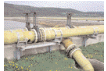
Rückhaltebecken für Salzabwasser
