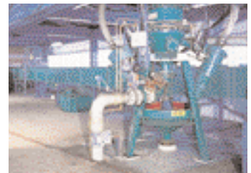
Rückstandsaufbereitung in Unterbreizbach, Thüringen
